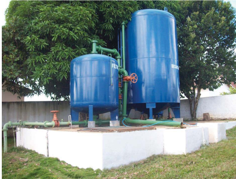
Figura 21 - ETA de Cruzeiro do Sul, EMBASA; 2016.
