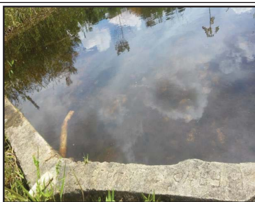
Barragem Captação- Atende 55 Ligações - Centenário - Vereda
