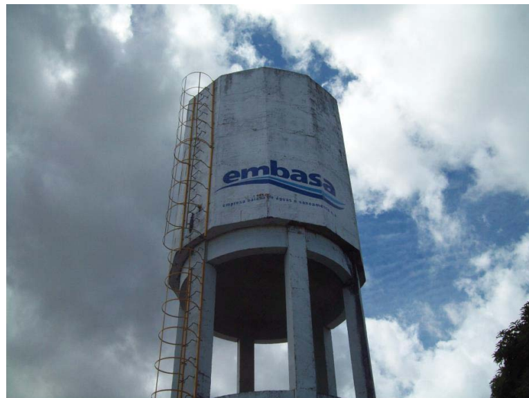
Figura 22 - Reservatório Elevado da ETA de Cruzeiro do Sul; EMBASA 2016.
