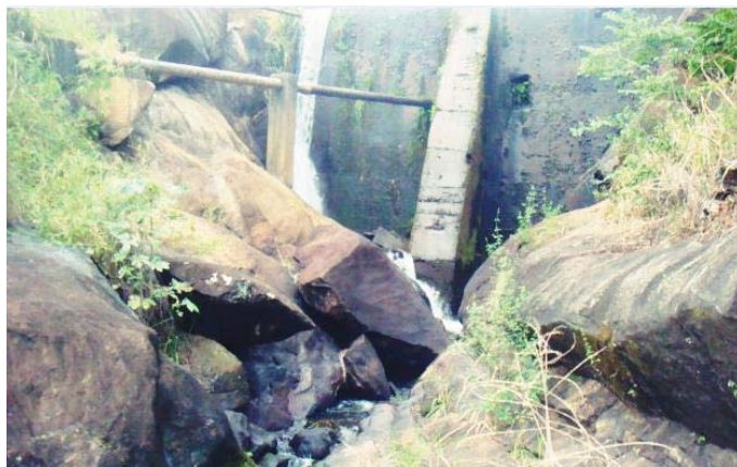
Figura 17 - Ponto de tomada d'água na barragem Santo Antônio; EMBASA 2016.
